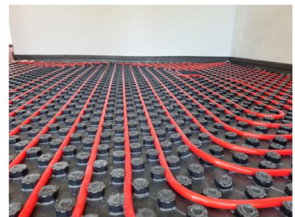
PAVIMENTO DI CHEMIDRO TUBAZIONI CLIMA IN PE-XC
